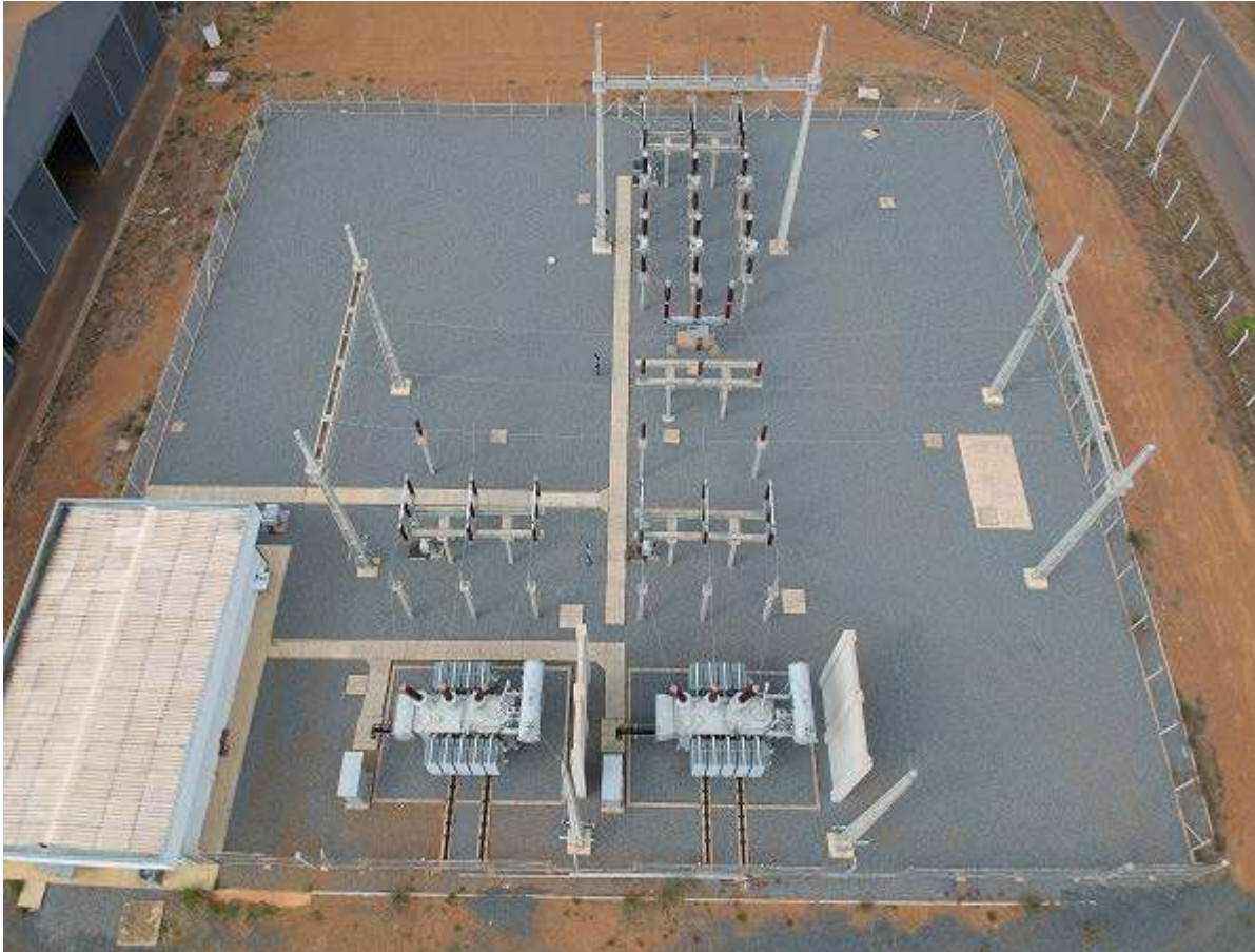
Figura 1 – Vista superior da instalação da subestação
